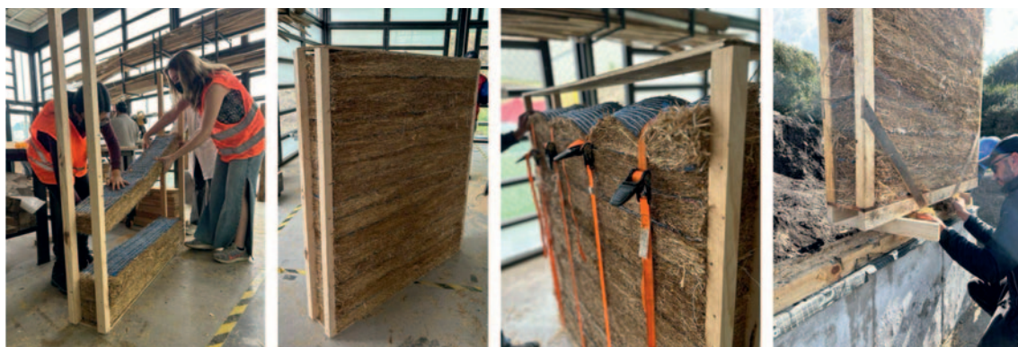
Figure 3 : De gauche à droite : 1. Préfabrication en atelier. 2. Panneau complet. 3. Compression supplémentaire. 4. Installation sur site, aperçu du panneau précédent sans enduit de terre.
